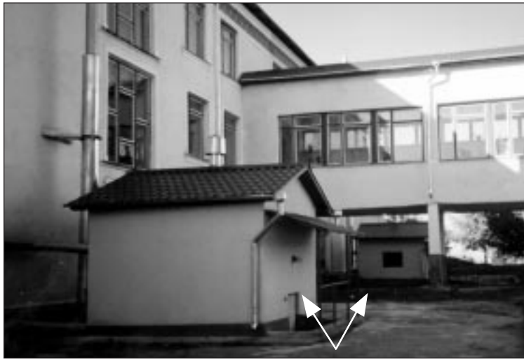
► Două minicazangerii moderne, care asigură două circuite interne independente ale sistemului de încălzire al școlii din Tîrnova
